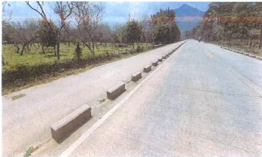
Toma de la Acera y Bordillo Intermitente en el Km 3+944 L. I., observese que ambos se mantienen en buen estado.
