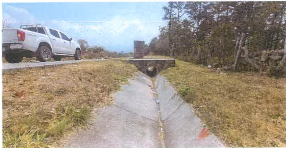
Toma del Acceso Lateral en el Km 5+167 L. I. Se puede ver que tanto su salida como su interior se mantienen limpios.
