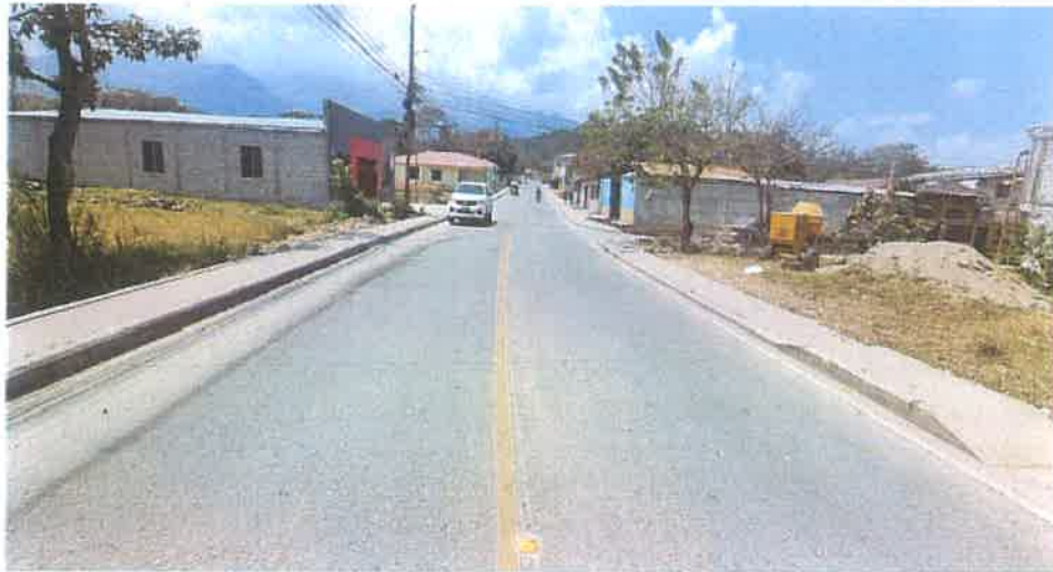
Imagen de la Pintura Termoplastica del Km 0+870 donde se puede observar que la de la línea central aun se mantiene en buen estado.
