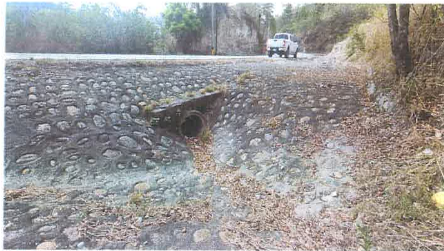
Toma de la Alcantarilla Transversal del Km 74+180 donde se puede observar su entrada completamente limpia.
