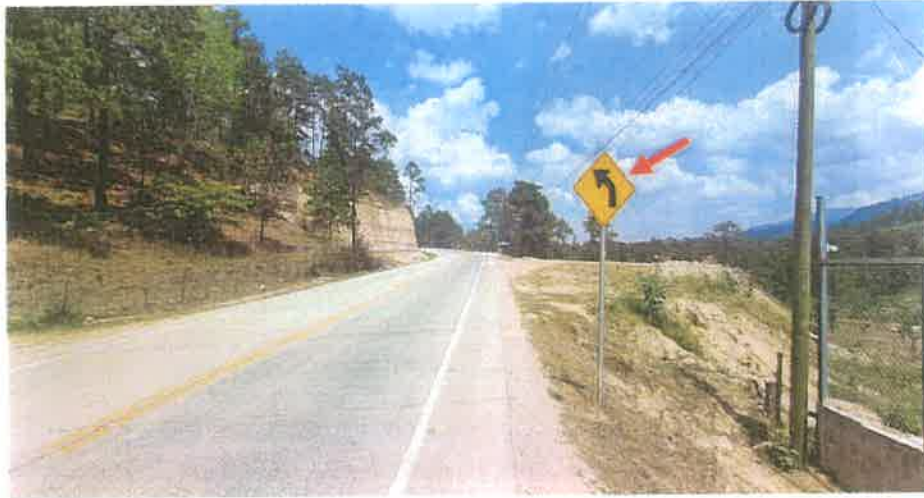
Toma de la Señal Vertical instalada en el Km 49+695 L. D., observese que aun se mantiene en buen estado y a plomo.
