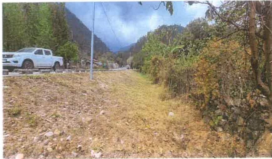
Toma de la Cuneta sin Enchape del Km 5+261 L. I. Se puede observar que esta limpia y sin erosiones.
