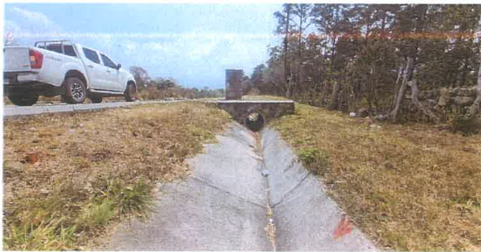
Toma del Acceso Lateral sin Pavimento en el Km 5+167 L. I., se puede ver que aun no se produce la grada entre la Acera y el relleno.
