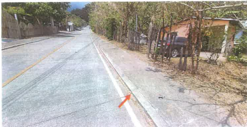
Toma de la Acera y Bordillo Continuo en el Km 5+326 L. D. Se puede observar que se mantienen en buen estado, limpia y completos.
