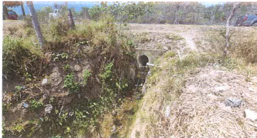
Toma de la salida de la Alcantarilla Transversal doble del Km 1+715. Se puede observar que sus interiores están completamente limpios.
