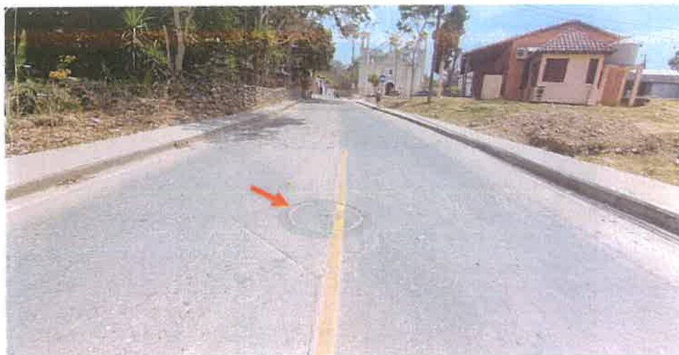
Toma de la Tapadera en el Pozo de Inspeccion en el Km 0+864. Se puede ver que esta en buen estado.
