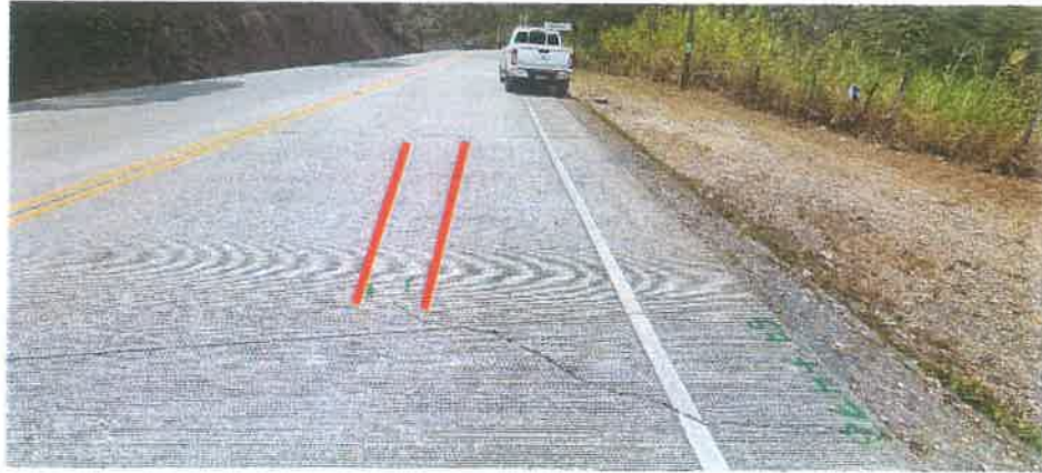
Sellar Grieta en tramo del Km 48+815 – 58+825 L. I.
