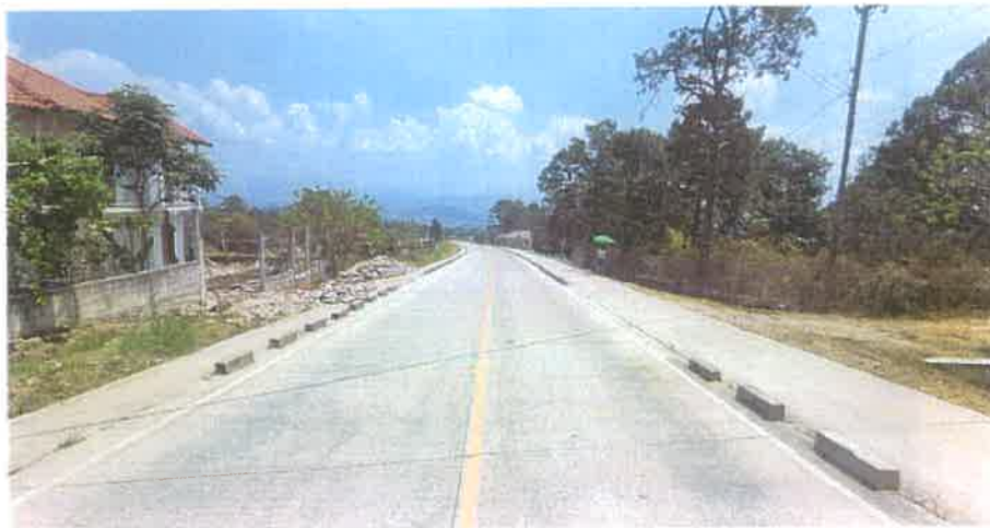
Toma de la Calzada de Rodadura del Km 3+655 donde se puede constatar que esta totalmente limpia y sin baches.
