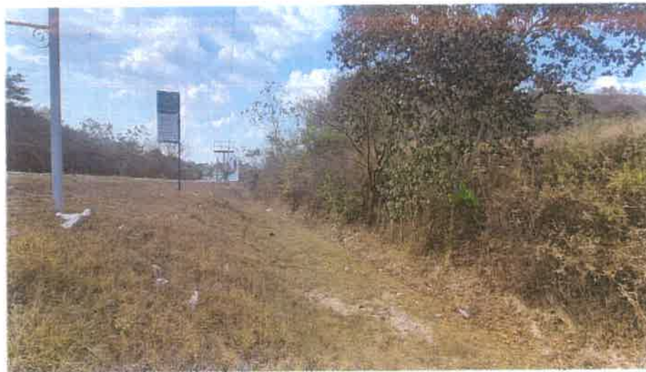
Toma de la Cuneta sin Enchape del Km 81+870 L. D. observese que se mantiene sin erosiones que pongan en riesgo la calzada.
