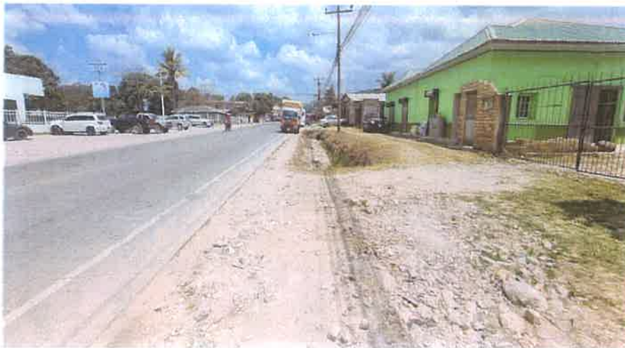
Toma del Acceso lateral sin Pavimento del km 48+780 L. D., observese que aún se mantiene sin producirse grada entre la losa y la cuña de B-C.
