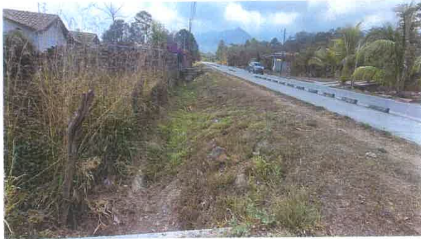
Toma de la Cuneta sin Enchape del Km 2+520 L. I., se puede ver que se mantiene sin erosiones que pongan en riesgo el terraplen.
