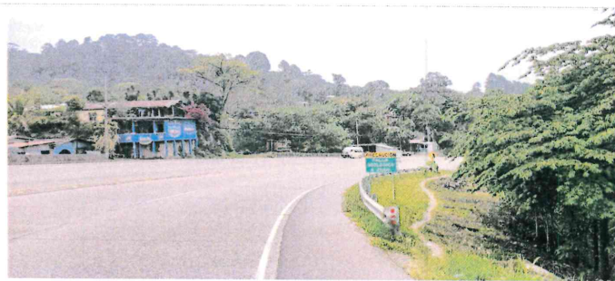
Falta de ampliación 158+200-158+400 y 159+500-162+300
