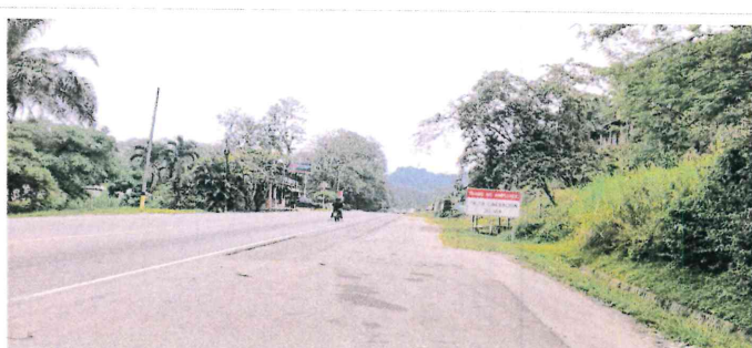
Falta de ampliación paso del lago de Yojoa, km. 154+000-155+000
