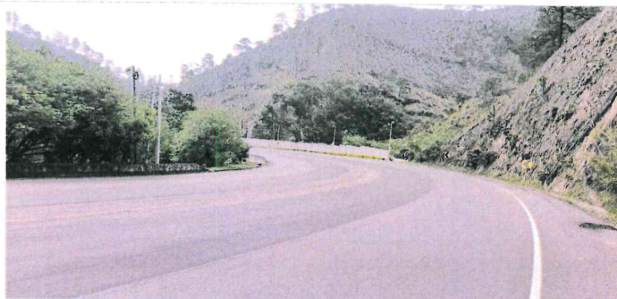
Falta de ampliación 158+200-158+400 y 159+500-162+300
