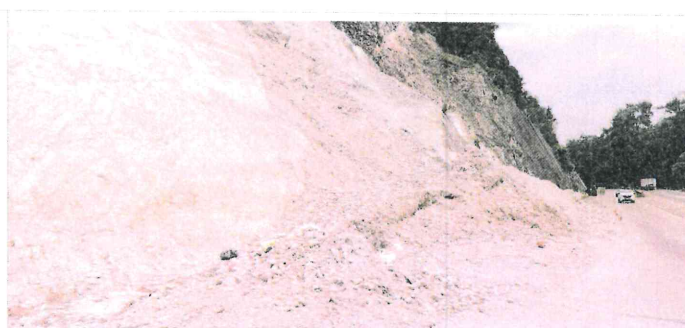
Aun no se retira derrumbe en sector de Carrizal Km. 131+300
