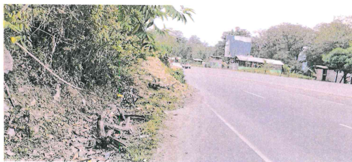
Aun no se retira derrumbe en sector de Bacadía Km. 149+700
