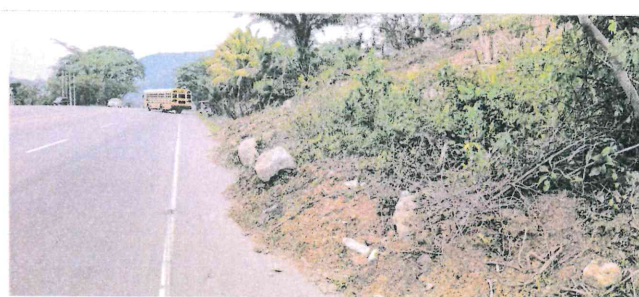
Aun no se retira derrumbe en sector de Bacadía Km. 149+700
