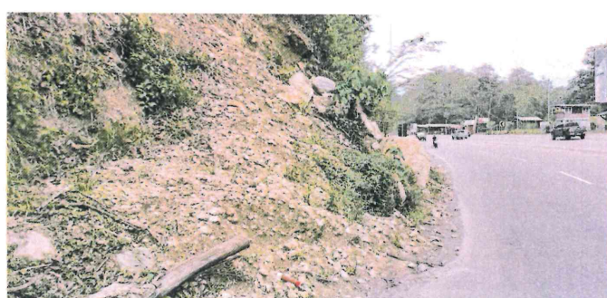
Aun no se retira derrumbe en sector de Bacadía Km. 149+700
