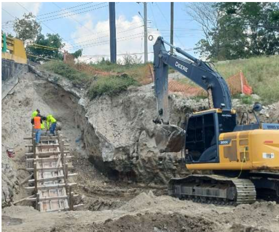
Colado de concreto de viga de protección para tubería de hierro negro de 24”.
