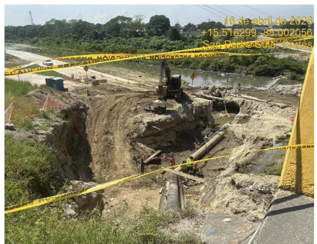
Se realizó excavación en talud entre la calle de acceso hacia los Cármenes y la rampa 1.
