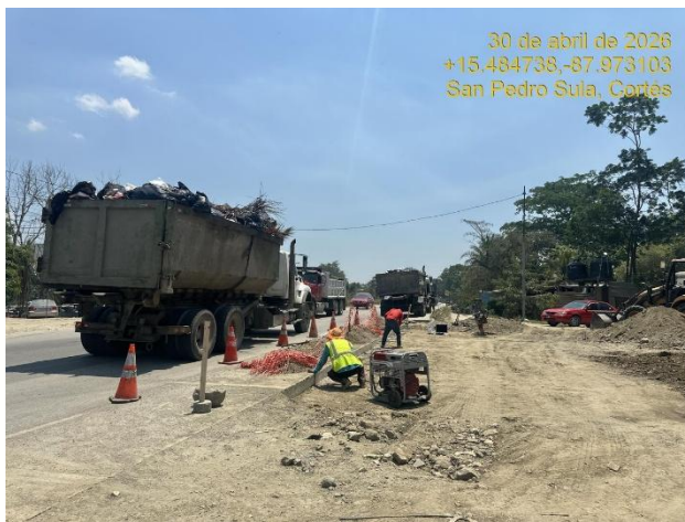
Personal de la empresa constructora en acceso hacia Col. San Vicente de Paul.
