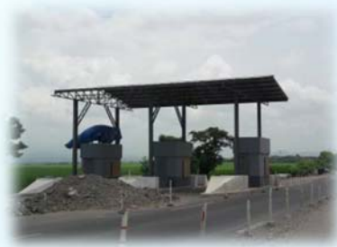
Vista cercana de la misma estación
