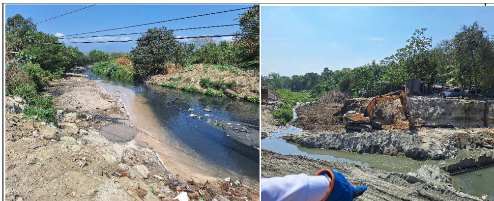
Fotografía 5: Aguas contaminadas en RIO BERMEJO Proyecto PUENTE JUCUTUMA No.1
