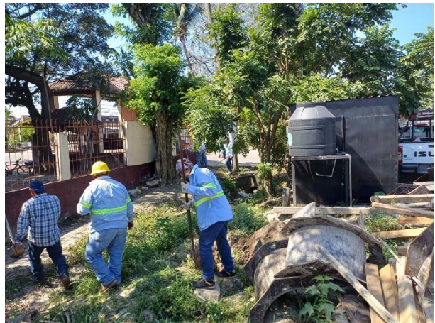
Personal de la ENEE marcando la ubicación de postes para cableado eléctrico.
