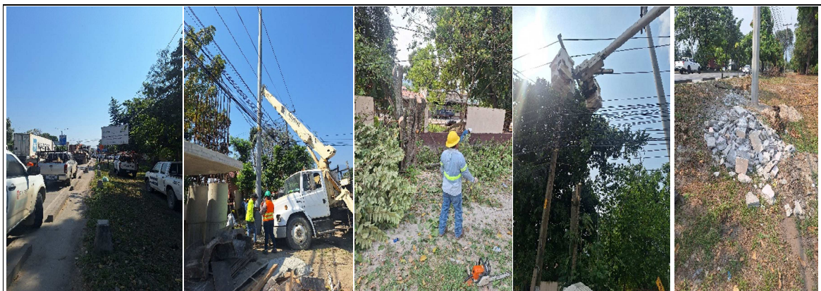
Fotografía 3: Situaciones que presentan riesgo ambiental
