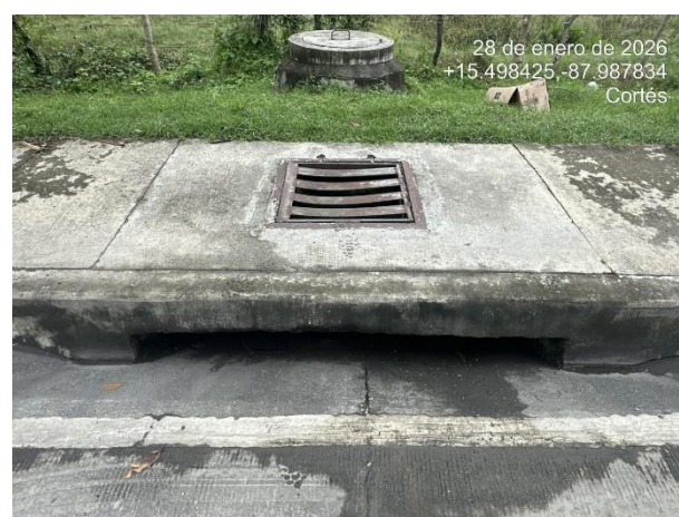
Tragante en parte norte limpio y funcional.
