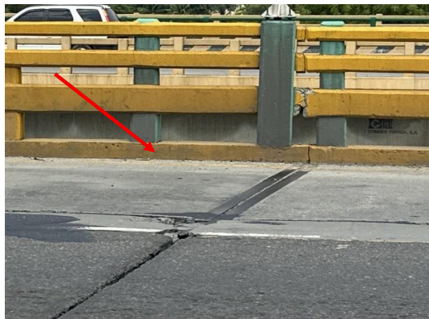
Falla encontrada en la junta longitudinal en agosto 2025.
