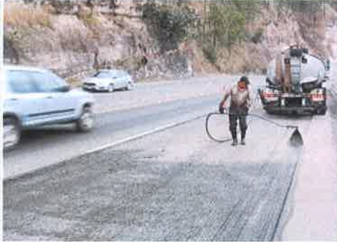
Foto 1. Comayagua - Siguatepeque Aplicación de liga asfáltica en caliente en toda la franja fresada.
