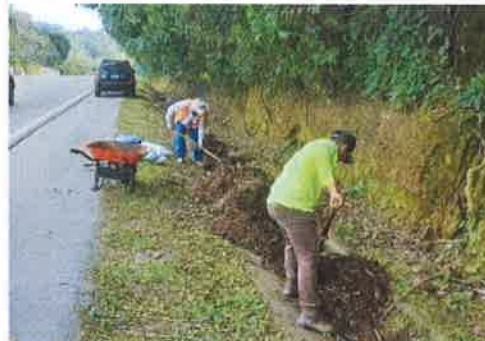
Foto 5. Estación 164 lado derecho Taulabé – Desvió a Santa Cruz de Yojoa Retiro de material azolvado en cuneta enchapada
