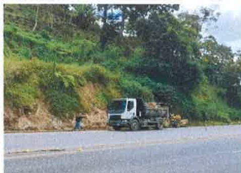
Foto 5. Estación 163 lado derecho Taulabé – Desvío a Santa Cruz de Yojoa Retiro de material azolvado en cuneta enchapada
