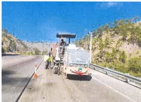
Foto 1. Estación 91 – 92.980 lado derecho Comayagua - Siguatepeque Fresado de carpeta asfáltica dañada, capa superior 5 cm.
