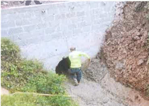
Foto 1. Estación 150+700 lado derecho Taulabé – Desvió a Santa Cruz de Yojoa Fundición de losa inferior en canal de salida, tubería TCR de 48"
