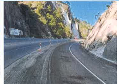
Foto 3. Estación 91 – 92.980 lado derecho Comayagua - Siguatepeque Fresado de carpeta asfáltica dañada, capa superior 5 cm.
