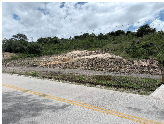
Se observa el talud de la zona de la falla km 77
