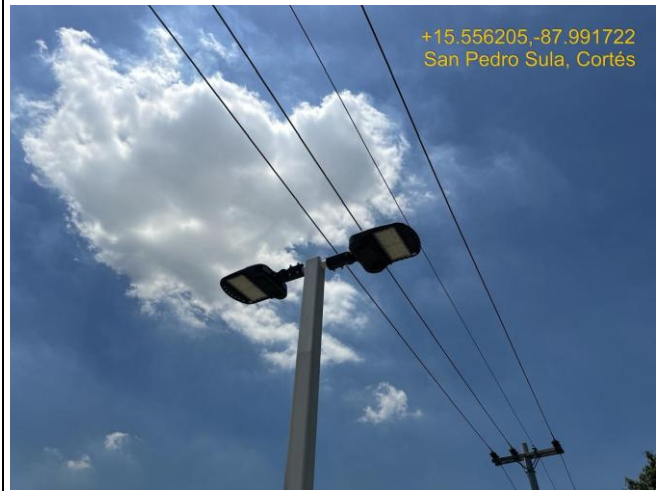
Lámparas en rampas en buen estado.
