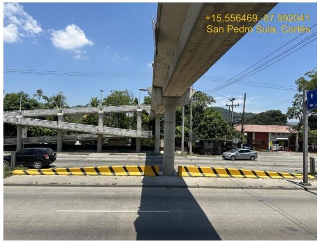
Pintura de barrera visible.
