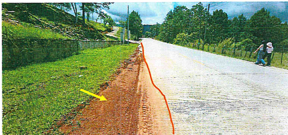
Calzada de Rodadura sucia en tramo del Km 53+586 – 53+616 L. I.
