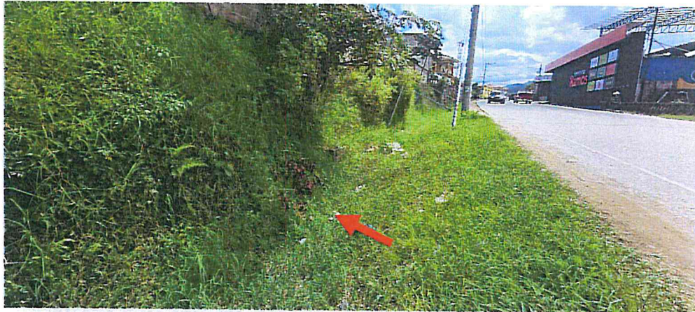
Cuneta Enchapada azolvada en el Km 48+807 – 48+912 L. D.
