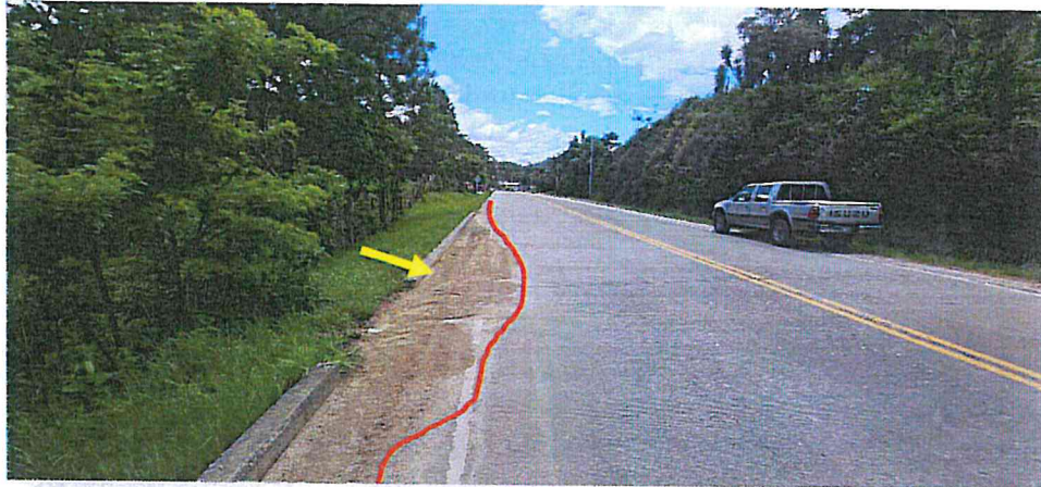
Calzada de Rodadura sucia en tramo del Km 61+760 – 61+880 L. D.
