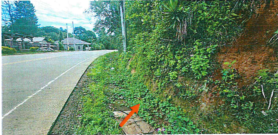
Cuneta Enchapada azolvada en el Km 57+023 L. D.
