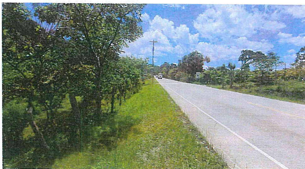
Toma del Derecho de Vía del Km 67+575 L. I., se puede constatar que se mantiene la maleza dentro de los Terminos de Contrato.
