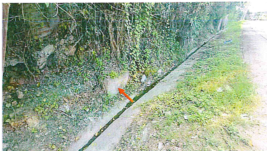
Caja de Registro construida en el Km 48+440 donde se puede observar que aun se mantiene en buen estado y sin problemas.
